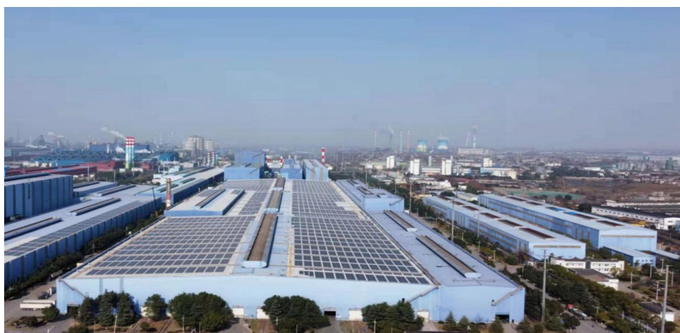
图 15-4 厂区屋顶分布式光伏项目
