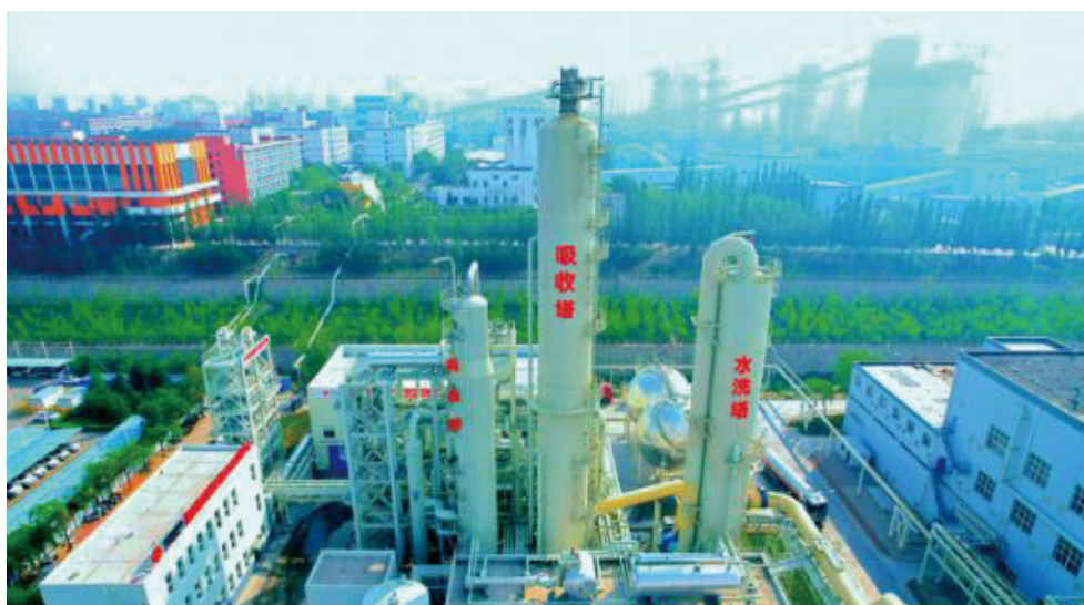
图 15-1 锦界电厂 15 万吨 / 年燃烧后碳捕集示范工程
